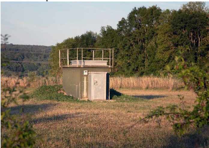
Un puit de pompage dans la nature à 35 km
